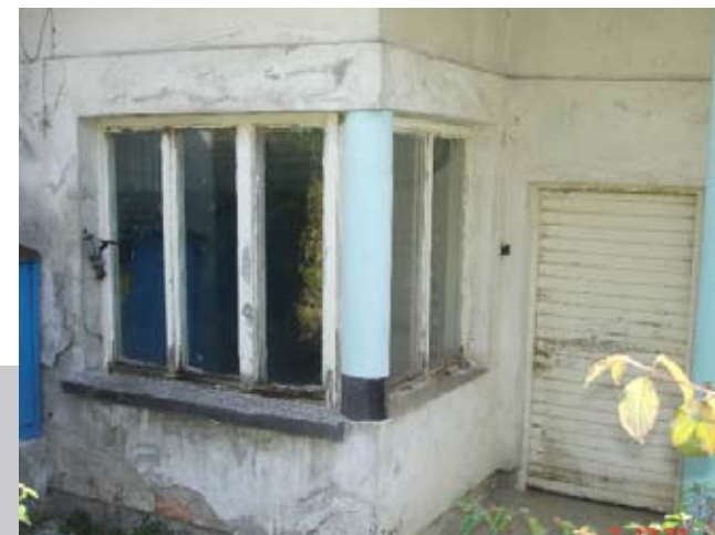
ПОМПЕНА СТАНЦИЯ ПЕТКОВА НИВА
