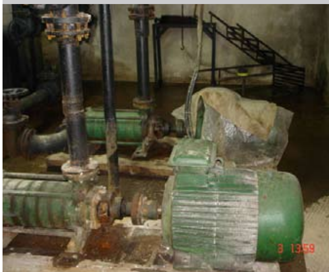
ПОМПЕНА СТАНЦИЯ ТОНЧЕВЦИ
